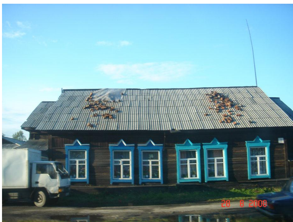
Рисунок 1. Разрушение печных труб в Култуке, Утулике и Слюдянке. Подобные эффекты имели массовый характер.
