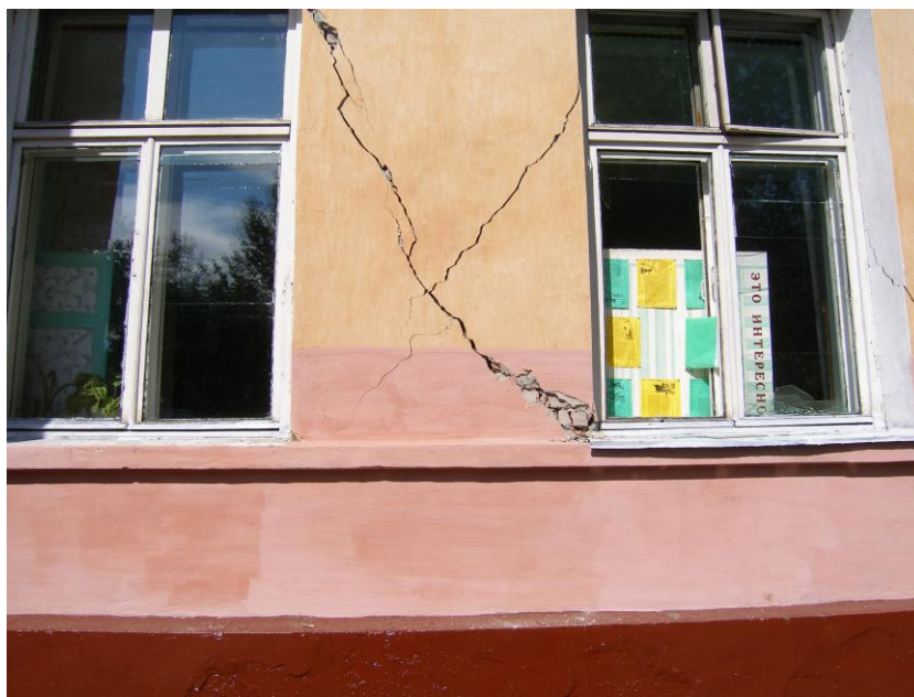
Рисунок 3. Трещины в стенах здания школы в п. Култук.
